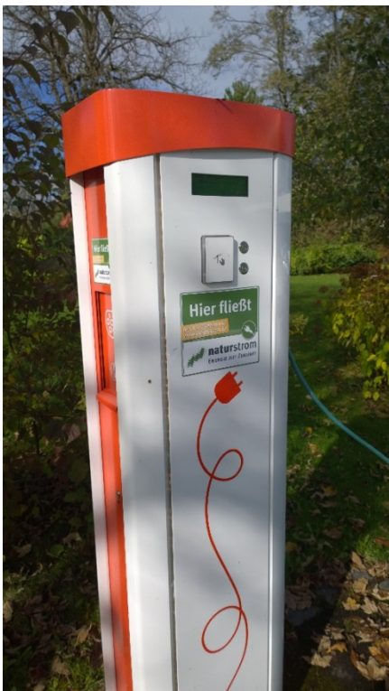
Abb. 16: Ladestation eines Elektroautos (Parkplatz vor Rathaus Oberhaching)
