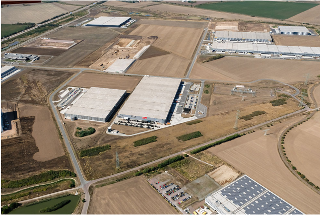
Abbildung 1 Baustelle zum Neubau eines Logistikzentrums im Stadtteil Peißen in Halle (Saale) (2019) Quelle: euroluftbild.de/Maika Glöckner
